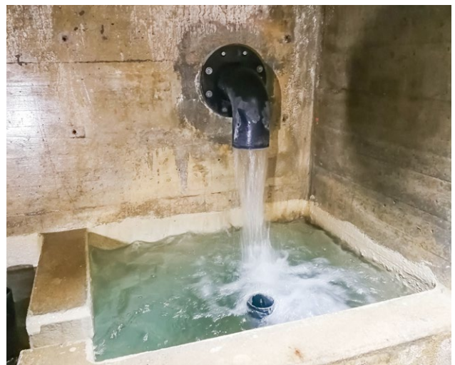
Quellfassung Brunn, Oberhofen AG.
